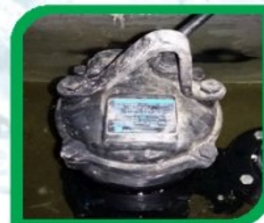
EFFLUENT PUMP & JET AERATOR
